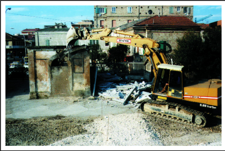
Montesilvano, anno 1987, cade un altro fabbricato ricco di ricordi: il primo Ufficio Postale ("grande velocità") poi destinato a magazzino...
