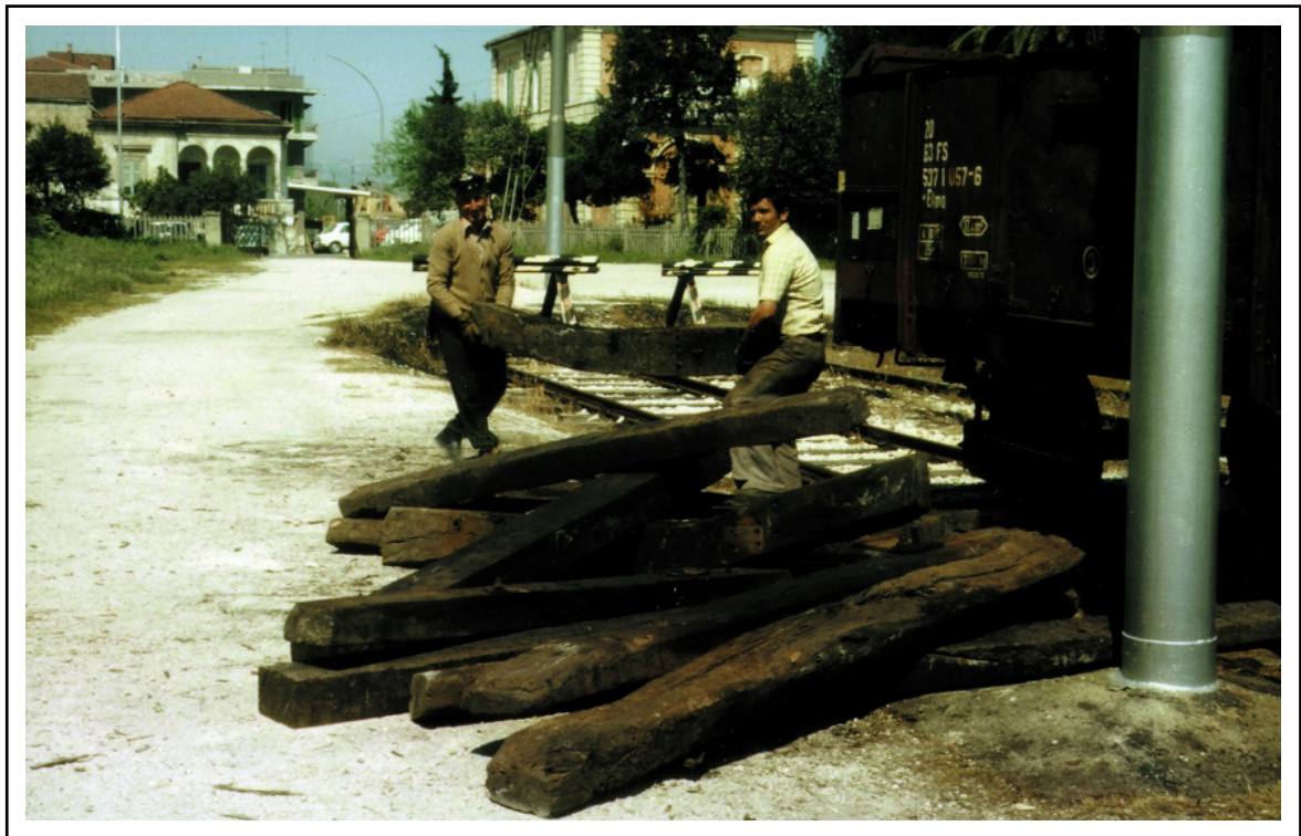
...e nello scalo merci, accantonamento traverse di servizio.
