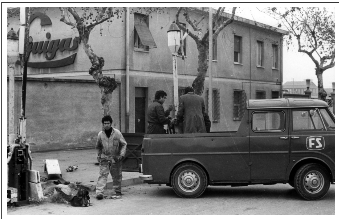
Montesilvano, anni '70, i tecnici della "I.E." Impianti Elettrici assicurano manutenzione al passaggio a livello di V.le Europa.
