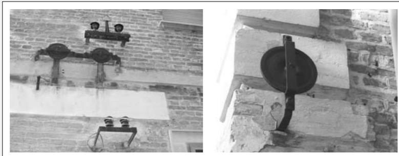
2008 - Particolari degli isolatori e delle carrucole per la manovra a filo dei segnali semaforici ad ala (ex stazione FEA Montesilvano spiaggia). - Collezione Salvatore Di Fazio
