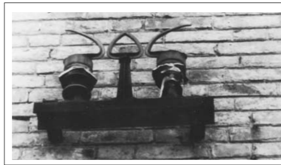
Anni '70 - Isolatori elettrici per stazioni F.E.A.. - Collezione Achille Rasetta.
